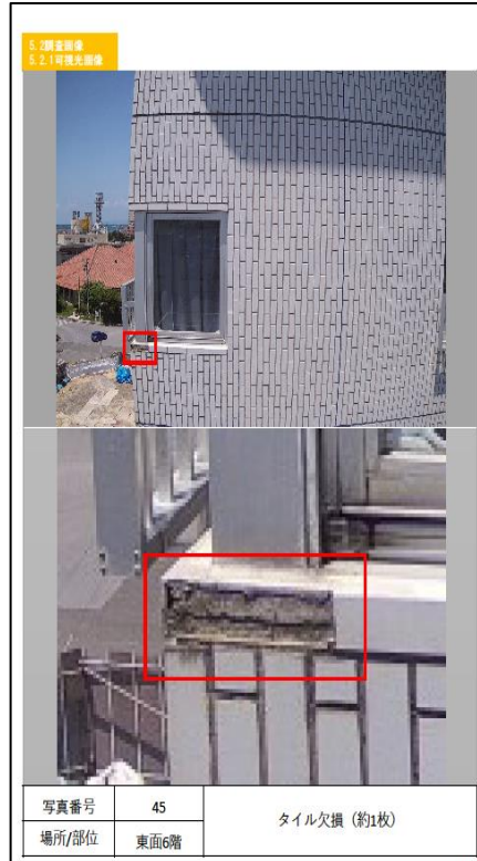
【タイル剥落・欠損】
